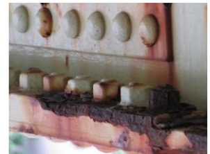
添接部の腐食状況
