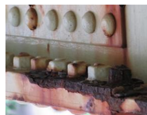
添接部の腐食状況
