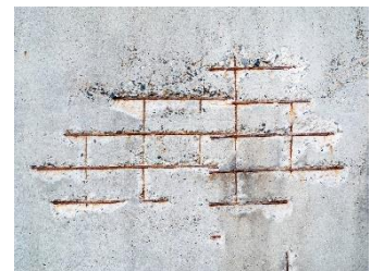
構造物のコンクリート露出鉄筋部
