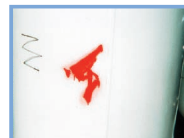
歩道橋橋脚の落書き
