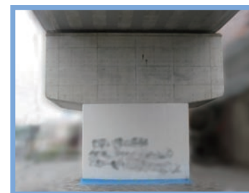
橋脚柱の落書き
