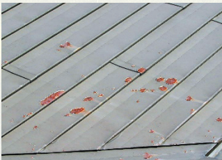
トタン屋根にさびが発生している
