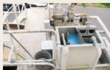
排水処理施設
