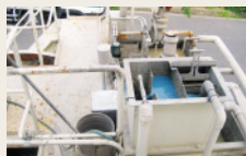
排水処理施設
