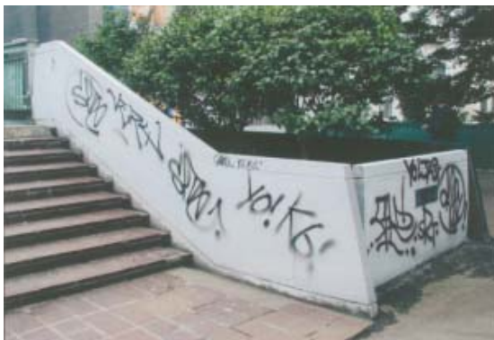
写真-1 落書き被害の例
